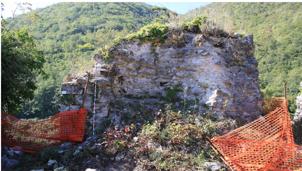
Fig.5 Vano C ad inizio lavori con i crolli ancora in posto
