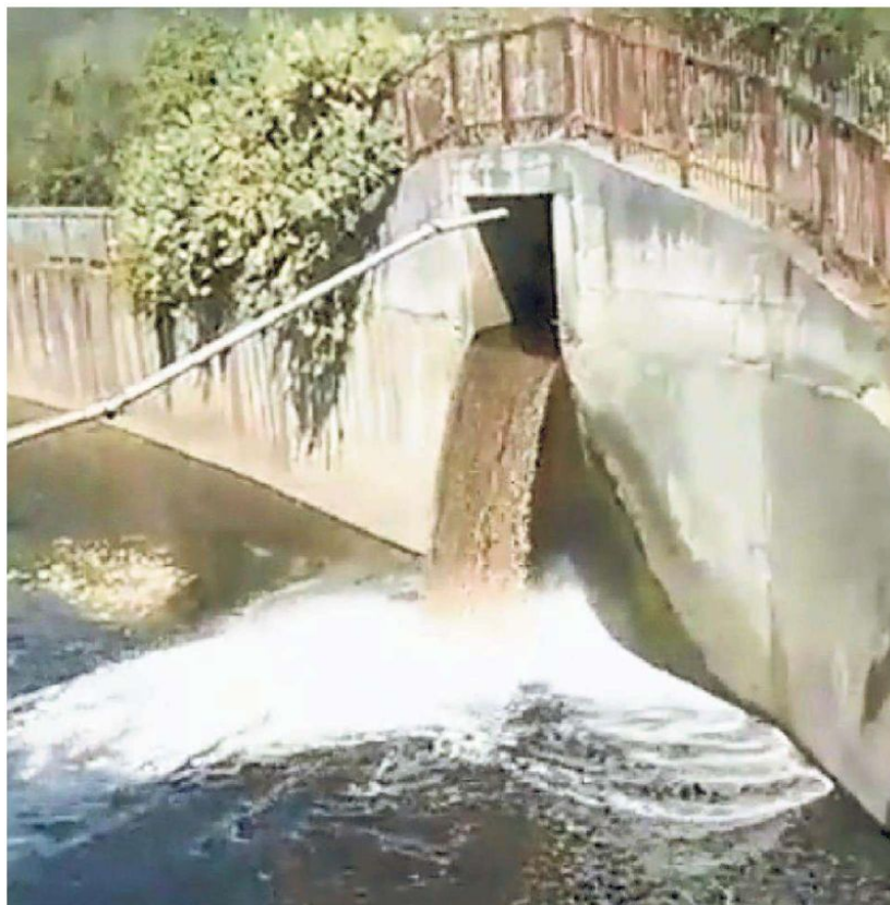
Uno scarico abusivo lungo il fiume Cavaiola
